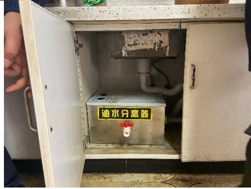
项目食堂隔油器
